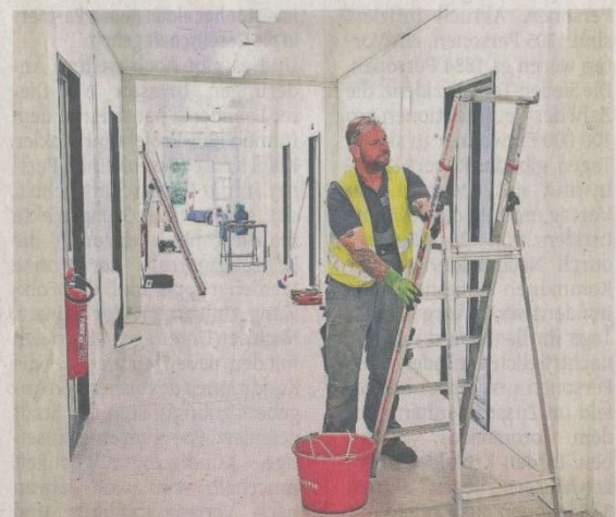
Innen werden die Container im Kaiser-Wilhelm-Park noch hergerichtet, ab Ende August können hier 40 Flüchtlinge unterkommen. Fotos: Andreas Bischof
